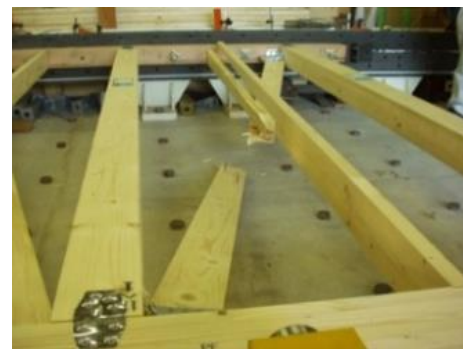
筋かいの破損
